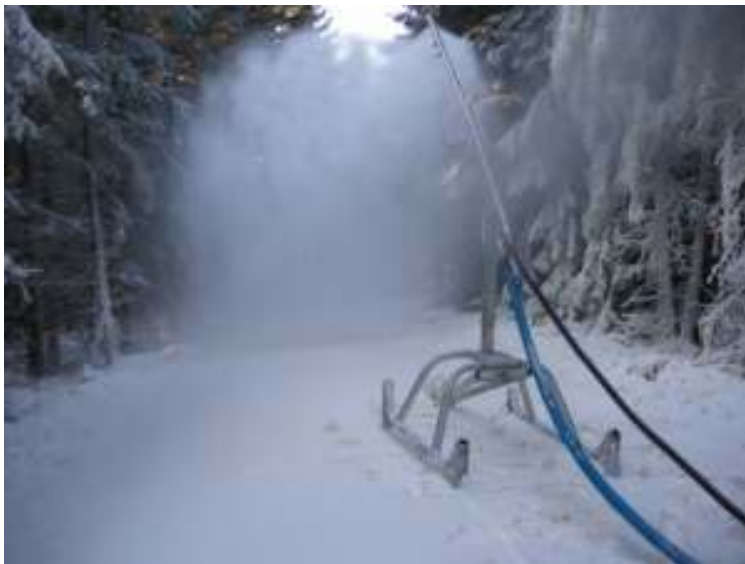
Bild 9. Flyttbar lans under snötillverkning. Anslutning med vatten och luft.
